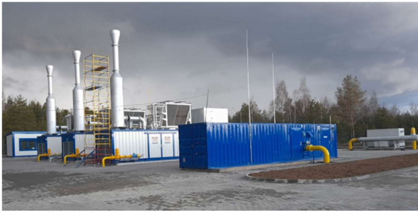
Bild 24: Deponie – Entgasungs - Anlage, Gesamtleistung über 7 MW
